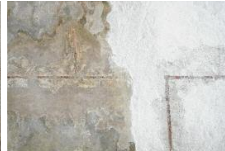
SÜDWAND DETAILS VORZUSTAND
