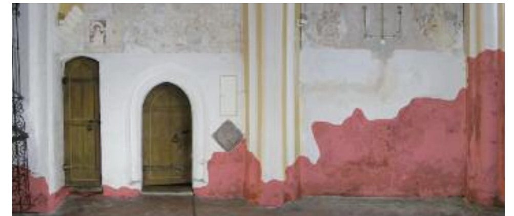
KARTIERUNG WAND NORDSEITE, IN ROT: GESCHÄDIGTE PUTZ- UND FASSUNGSBEREICHE
