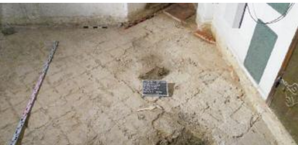
SAKRISTEI VORZUSTAND PILZGEFLECHT UNTER HOLZBODEN BAROCKZEITLICHES MÖRTELBETT
