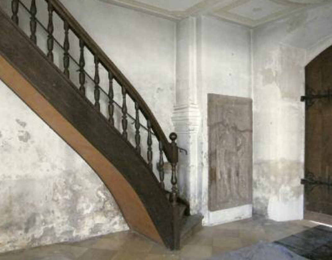
VORZUSTAND UND SCHADENSBIlder
