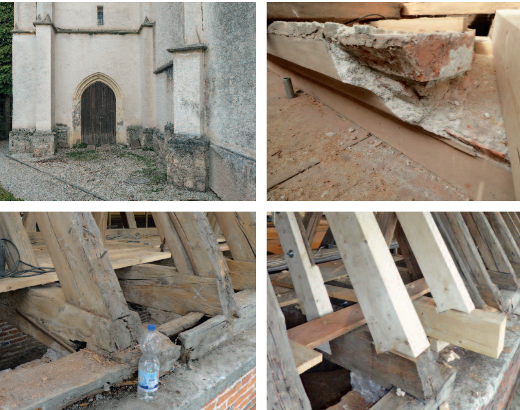
VORZUSTAND UND SCHADENSBI LDER
