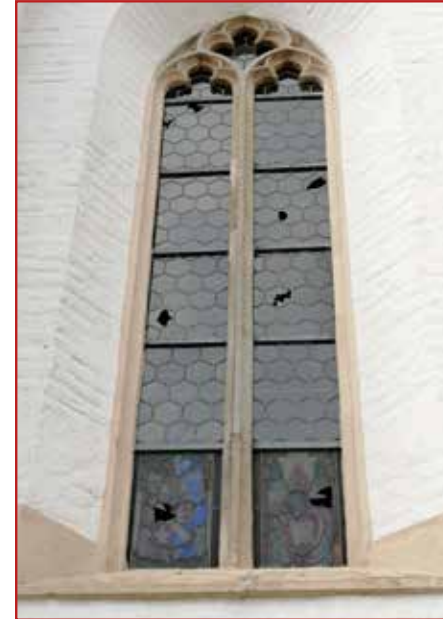
Fensterschäden in St. Georg, Ast
